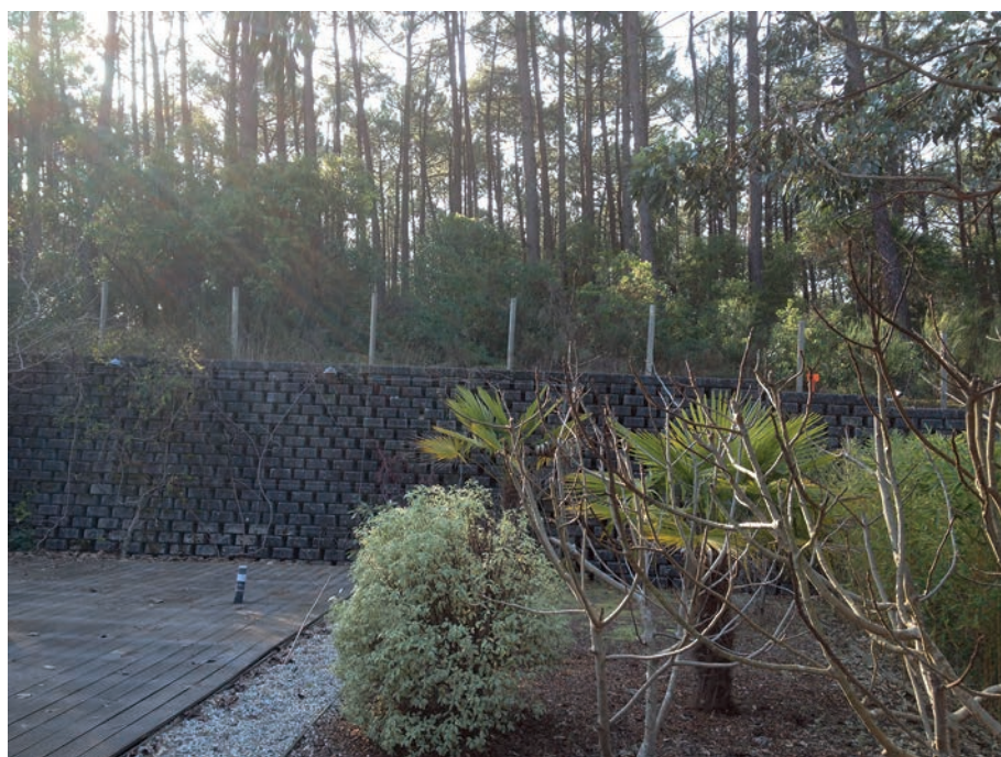
Photo : un mur actuel compense ce fort dénivelé et protège les résidences voisines.
