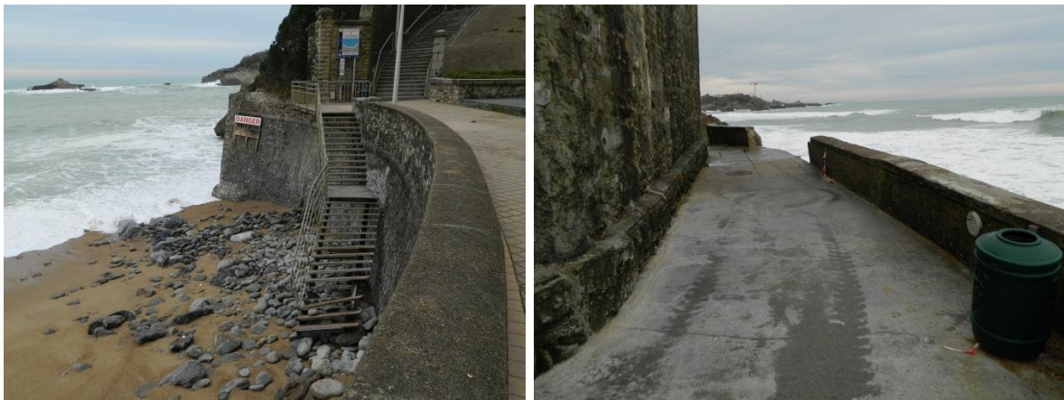
Figure 83 - Gauche : endommagement de l'escalier d'accès à la plage à l'extrémité Nord de la Grande plage ; Droite : destruction du parapet du perré au droit de l'Hôtel du Palais (Biarritz, 09/01/2014, BRGM).
