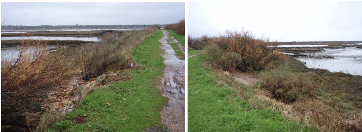
Figure 76 – Érosion généralisée du pied de la digue protégeant le domaine endigué de Certes (Audenge, 23/01/2014, BRGM).
