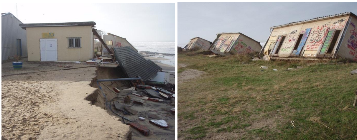
Figure 10 - Gauche : effondrement du club de surf au Sud de Soulac ; Droite : effondrement de 3 anciens bâtiments du camping Sud (Soulac-sur-Mer, 07/01/2014, BRGM).
