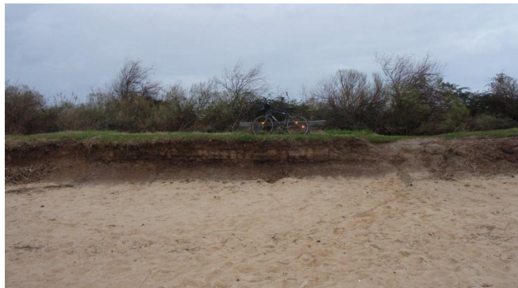
Figure 72 – Érosion marquée de la digue sur la plage de Graveyron (Audenge, 23/01/2014, BRGM).
