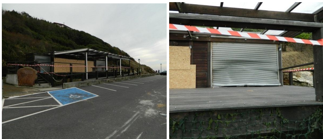
Figure 105 - Enfoncement des portes métalliques du 2 ème restaurant de la jetée des Alcyons et endommagement de la terrasse (Guéthary, 09/01/2014, BRGM).
