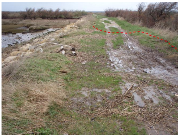
Figure 74 – Surverse marine (tirets rouges) et érosion des terrains au sommet des enrochements sur le domaine de Graveyron (Audenge, 23/01/2014, BRGM).
