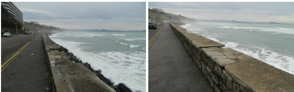
Figure 86 - Altération du parapet du perré au Nord de la Côte des Basques (Biarritz, 09/01/2014, BRGM).
