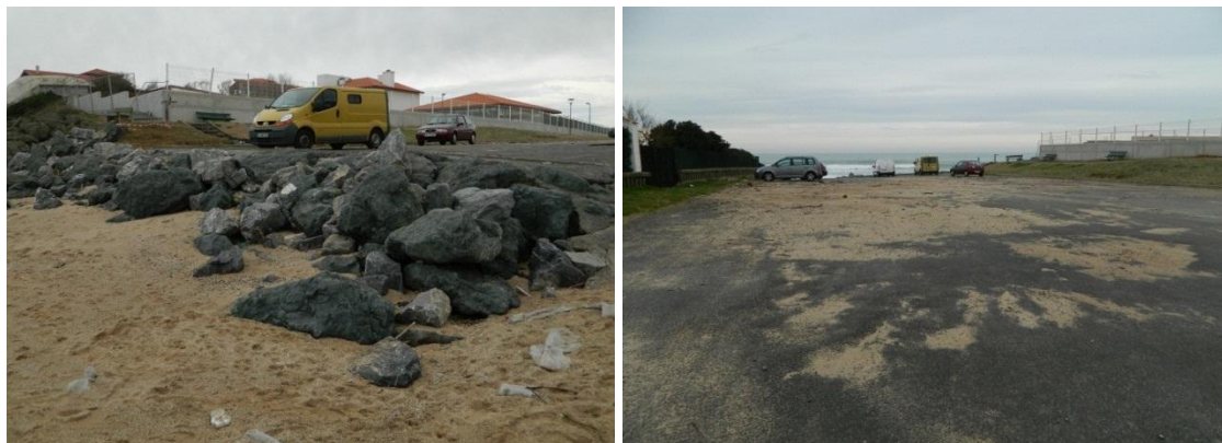
Figure 96 - Gauche : fragilisation des enrochements du parking des Embruns ; Droite : submersion au \frac{3}{4} du parking (Bidart, 09/01/2014, BRGM).
