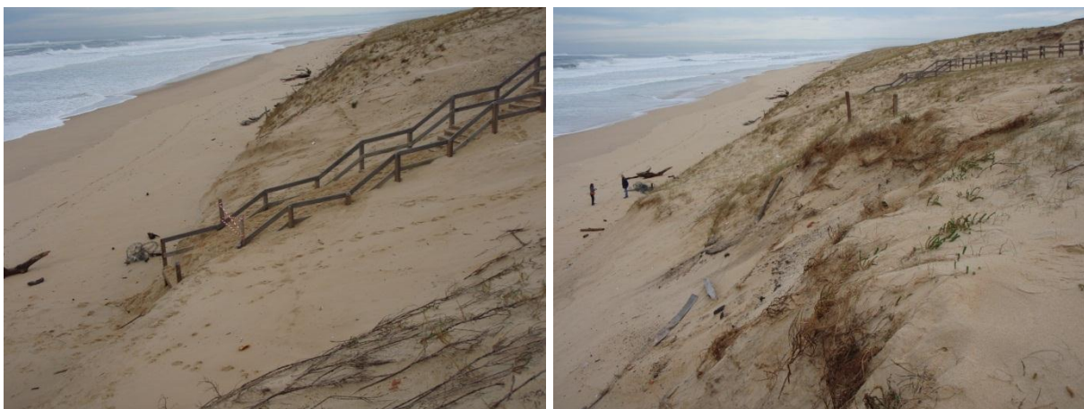
Figure 46 - Gauche : destruction de la base de la descente de plage ; Droite : entaille d'érosion au Sud de la descente de plage (Messanges, 08/01/2014, BRGM).
