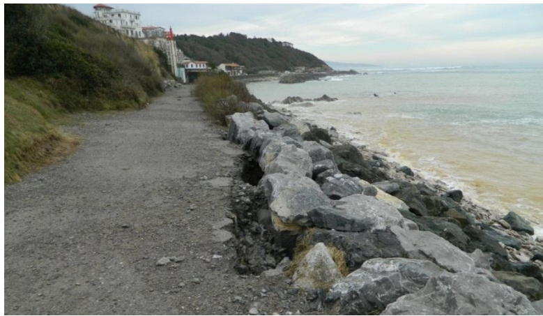
Figure 101 - Déstabilisation des enrochements sur le sentier du littoral de Parlementia (Bidart, 09/01/2014, BRGM).
