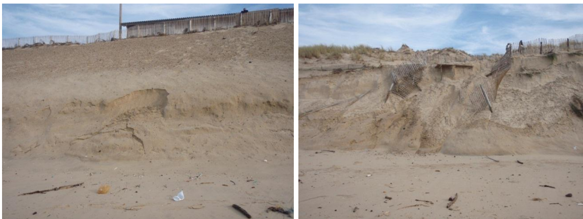
Figure 14 - Gauche : falaise active au droit du poste de secours ; Droite : destruction d'un accès de plage (Carcans, 07/01/2014, BRGM).
