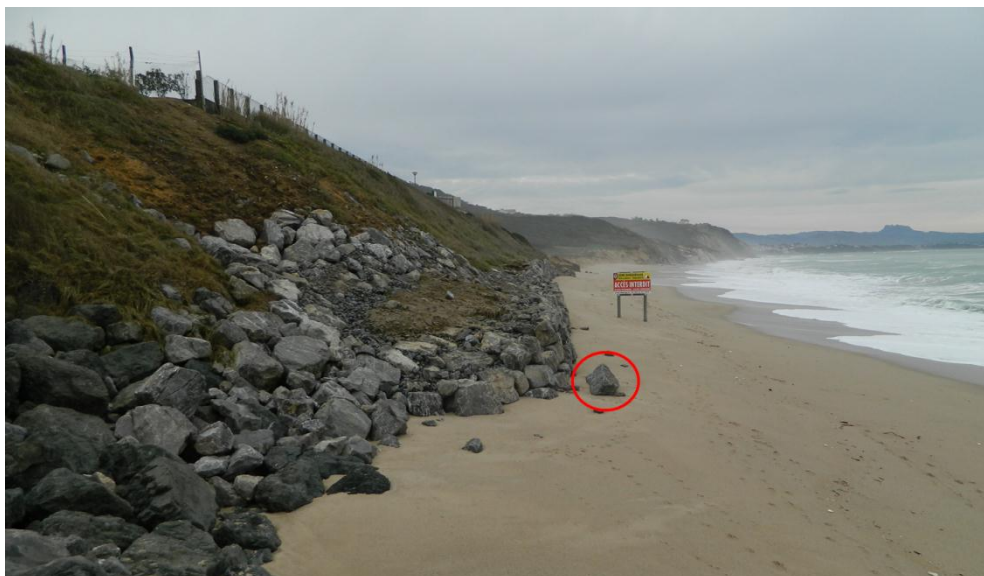
Figure 92 - Fragilisation des enrochements sur la plage de Pavillon Royal. Un bloc s'est désolidarisé et a été retrouvé en haut de plage à la suite de l'évènement du 6-7 janvier (Bidart, 09/01/2014, BRGM).
