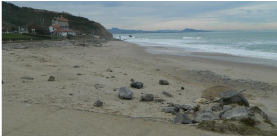
Figure 91 - Déstabilisation des enrochements, accès Nord, plage d'Ilbarritz (Bidart, 09/01/2014, BRGM).
