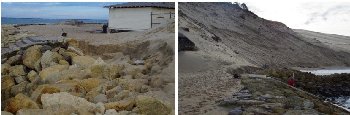
Figure 25 - Dégradation du Musoir de la Corniche (La-Teste-de-Buch, 08/01/2014, BRGM).
