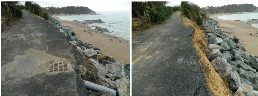
Figure 107 - Attaque des altérites du sentier du littoral par les vagues de tempête et déstabilisation des enrochements (Saint-Jean-de-Luz, 09/01/2014, BRGM).
