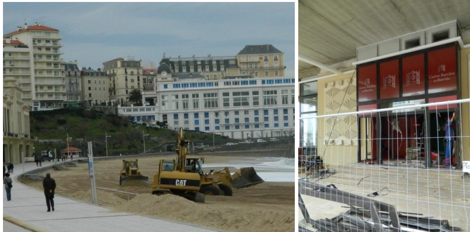
Figure 84 - Gauche : remodelage du sable sur la Grande plage faisant suite à son utilisation pour le merlon de protection du casino ; Droite : réparation des baies vitrées du casino, détruites dans la nuit du 6 au 7 janvier (Biarritz, 09/01/2014, BRGM).
