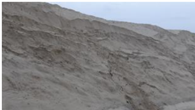
Figure 33 - Érosion au droit de l'héliport de la Plage du Vivier (Biscarrosse, 07/01/2014, ONF).
