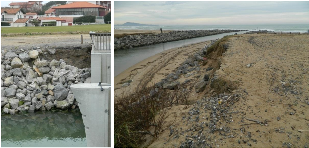
Figure 95 - Fragilisation des enrochements sur la rive droite du débouché de l'Uhabia (Bidart, 09/01/2014, BRGM).
