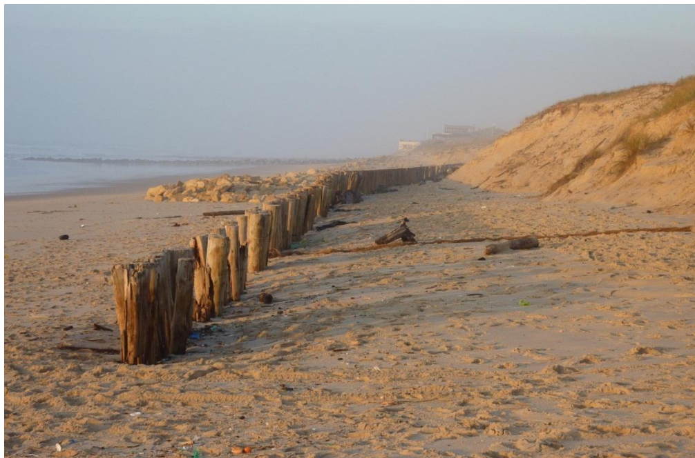
Figure 17 – Recul du pied de dune de plus de 10 m entre le 1 er et 9 janvier 2014, entre l'héliport et la fin des pieux (Lacanau, 09/01/2014, GIP Littoral Aquitain).
