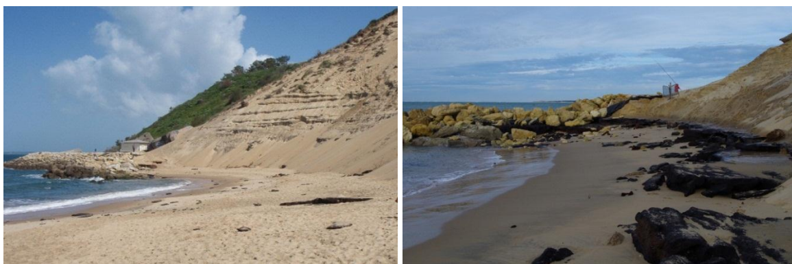
Figure 28 - Érosion de la plage, apparition du paléosol, à gauche : avril 2013, à droite : janvier 2014 (08/01/2014, BRGM).
