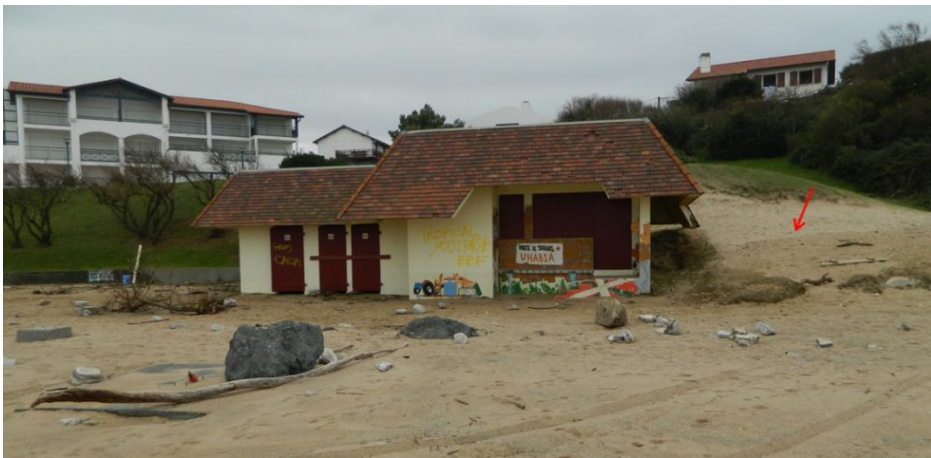
Figure 98 - Le poste de secours de la plage d'Uhabia a subi l'action du jet-de-rive. Le runup (hauteur maximale du jet-de-rive) est matérialisé par le sable plus foncé sur l'accès de plage (Bidart, 09/01/2014, BRGM).
