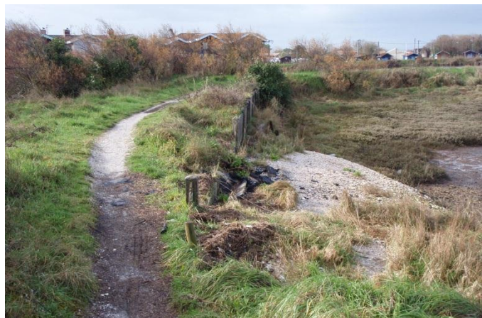
Figure 78 – Exemple d'un point sensible face à l'érosion marine au niveau de la digue de la maline de l'Ascot entre les ports de Gujan et Larros (Gujan-Mestras, 23/01/2014, BRGM).
