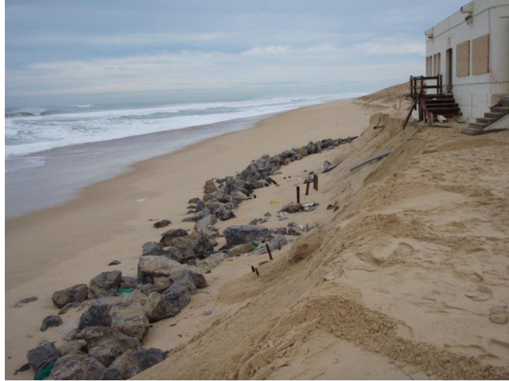
Figure 47 - Érosion au niveau du restaurant et vue sur la dune Nord érodée (Vieux-Boucau, 08/01/2014, BRGM).
