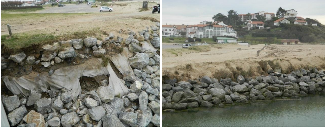
Figure 94 - Fragilisation des enrochements sur la rive gauche du débouché de l'Uhabia (Bidart, 09/01/2014, BRGM).
