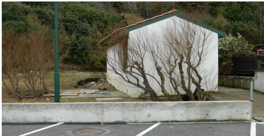
Figure 103 - La force des vagues a générée une microfalaise d'érosion sur le terrain de cette maison. Le jet-de-rive a atteint le pied des buissons en arrière du bâtiment (Guéthary, 09/01/2014, BRGM).
