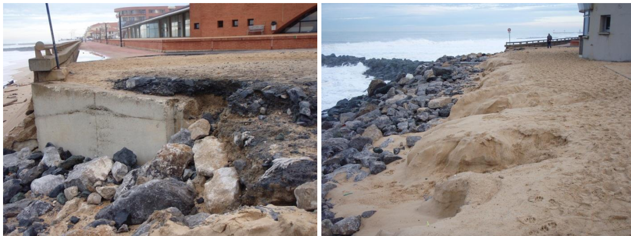
Figure 51 - Gauche : altération des enrochements au Nord de la Plage de la Savane ; Droite : érosion du stock sableux surplombant les enrochements (Capbreton, 08/01/2014, BRGM).
