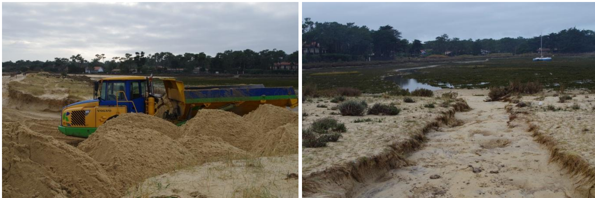
Figure 63 - Exemple de brèche au niveau de la flèche sableuse du Mimbeau (Lège-Cap-Ferret, 09/01/2014, BRGM).
