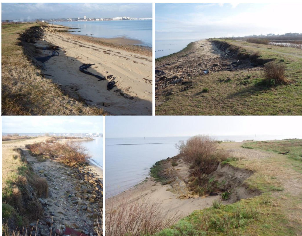
Figure 79 - Érosion du talus de la digue des Prés Salés Est (La-Teste-de-Buch, 23/01/2014, BRGM).
