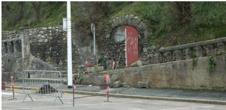
Figure 87 - Destruction du garde-corps d'un chemin de promenade le long du Boulevard du Prince de Galles (Biarritz, 09/01/2014, BRGM).
