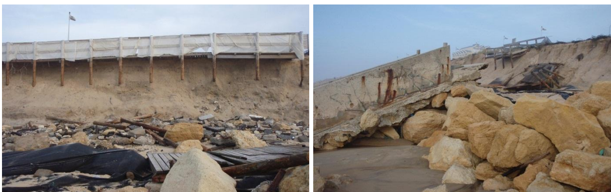
Figure 15 - Déchaussement de la promenade de bord de mer en bois. Gauche : zone de l'escalier n°1 (le plus au Nord) ; Droite : zone de l'escalier n°2 (Lacanau, 07/01/2014, BRGM).
