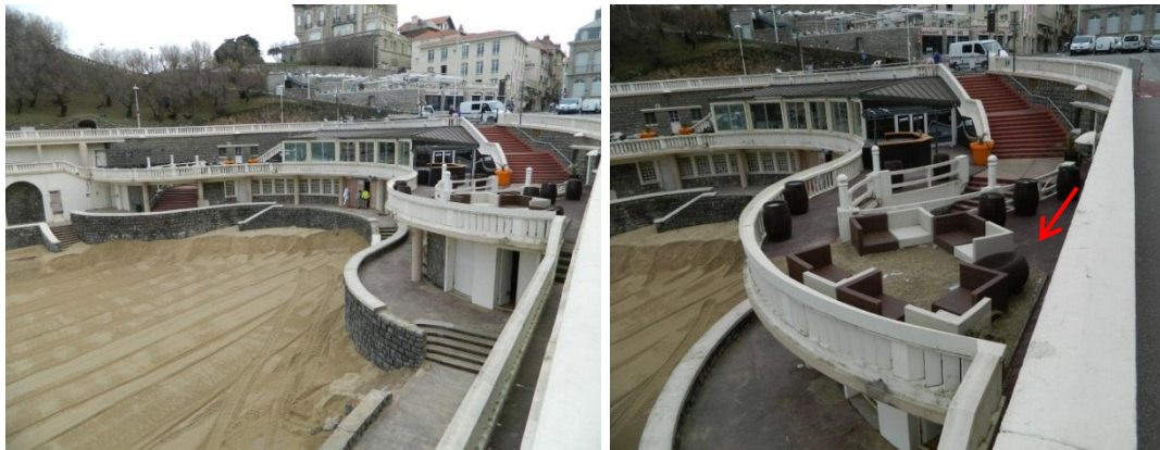
Figure 85 - Gauche : dégâts visibles sur le bâtiment, le parapet et les garde-corps du Port-Vieux ; Droite : laisse de mer (flèche rouge) atteignant la terrasse du restaurant (Biarritz, 09/01/2014, BRGM).
