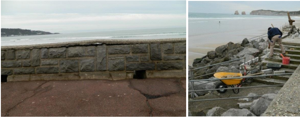
Figure 109 - Gauche : endommagement du parapet du perré du Boulevard de la Mer ; Droite : travaux de reconstruction de l'accès de plage touché durant les coups de mer (Hendaye, 09/01/2014, BRGM).
