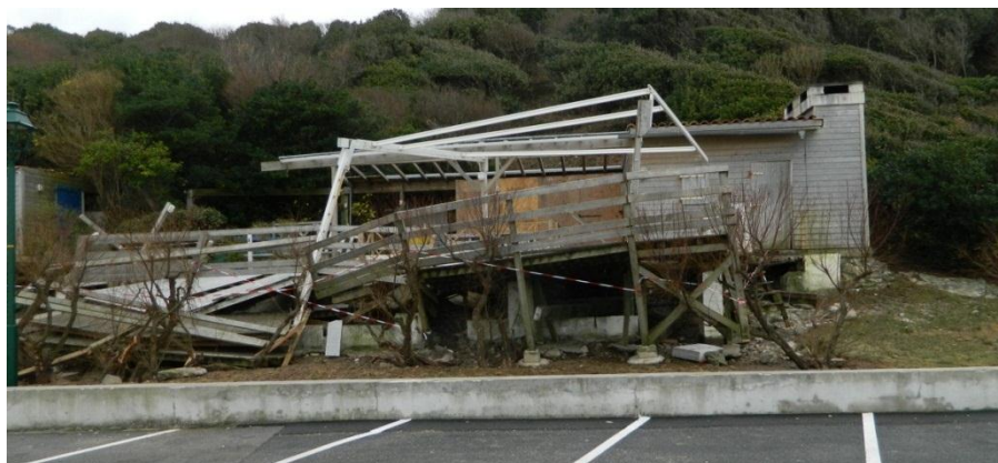
Figure 104 - Destruction de la terrasse du 1 er restaurant de la jetée des Alcyons (Guéthary, 09/01/2014, BRGM).
