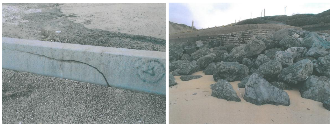
Figure 93 – Gauche : détérioration du parapet en béton à l'extrémité de la promenade ; Droite : fragilisation des enrochements sur la plage avec désolidarisation de plusieurs blocs (Bidart, 07/01/2014, Services Techniques, Mairie de Bidart).
