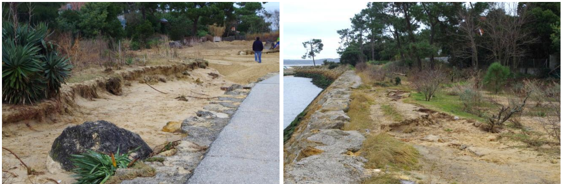
Figure 67 - Dégradation de l'ouvrage sous l'effet des vagues, franchissement par paquets de mer et érosion au sommet et en arrière de l'ouvrage (Lège-Cap-Ferret, 09/01/2014, BRGM).
