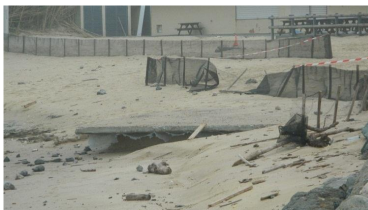
Figure 89 - Affouillement d'une dalle sur la plage de Milady (Biarritz, 09/01/2014, BRGM).
