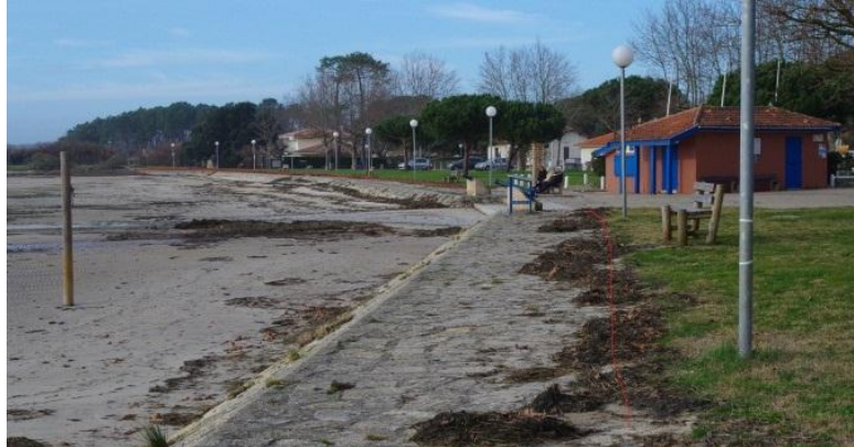
Figure 71 - Laisse de mer témoignant du débordement au-dessus du perré (Arès, 07/01/2014, BRGM).
