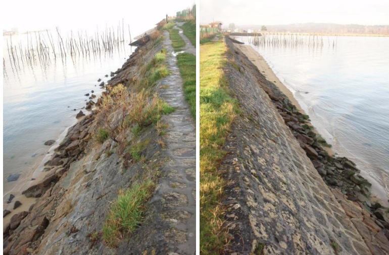
Figure 80 – Afouillement à la base des perrés des digues des Prés Salés Est (La-Teste-de-Buch, 23/01/2014, BRGM).
